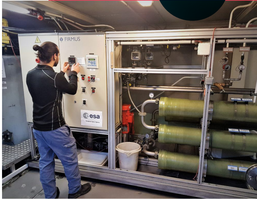
Système de recyclage des eaux de Concordia, la station franco-italienne de l'Antarctique. The water recycling system at Concordia, the French-Italian station in Antarctica.
